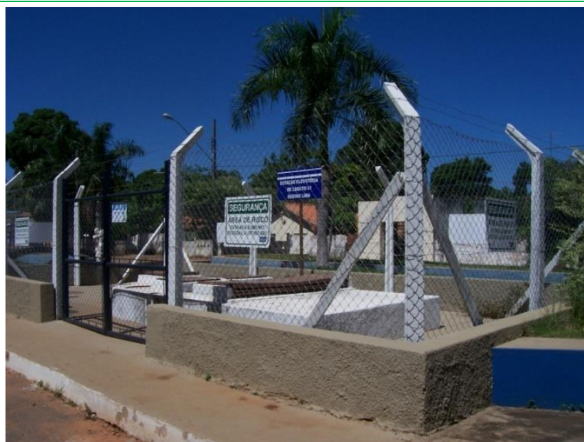
Figura 3.14 – Estação elevatória de esgoto localizada na Vila Maciel.
